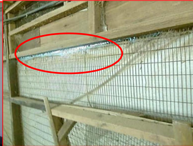
POTENSI KEBOCORAN CURTAIN
